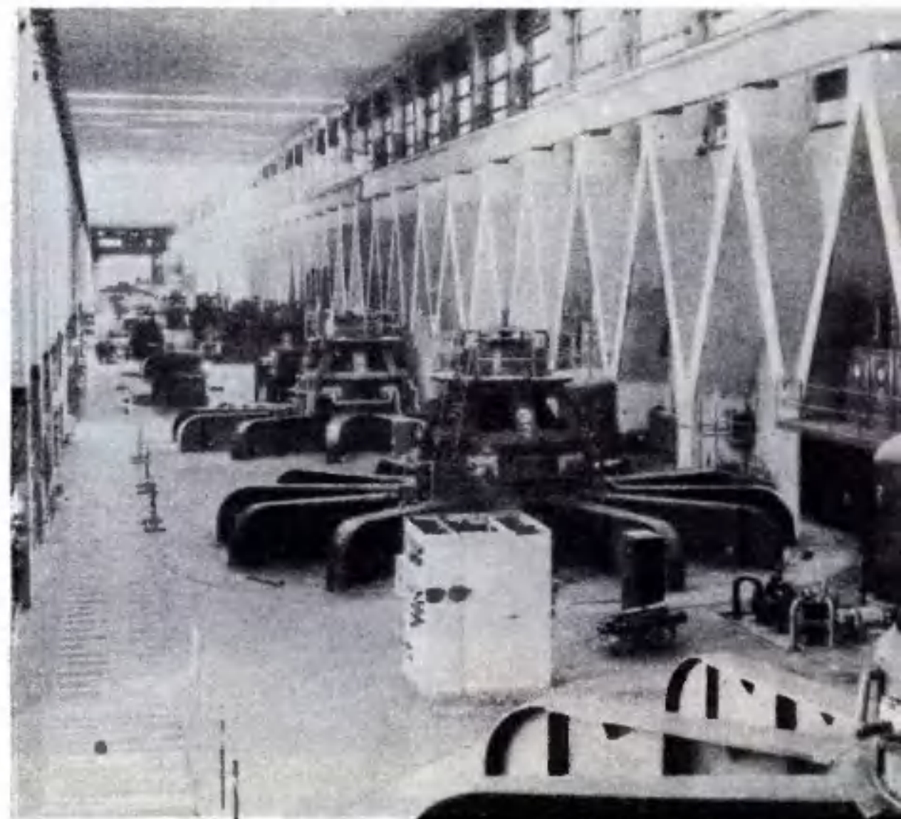
Машинный зал Братской ГЭС.
